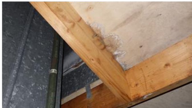
Fuktfläck på insida träfiberskiva på vinden
