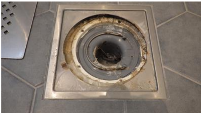
Golvbrunn utan synlig brunnsmanschett
