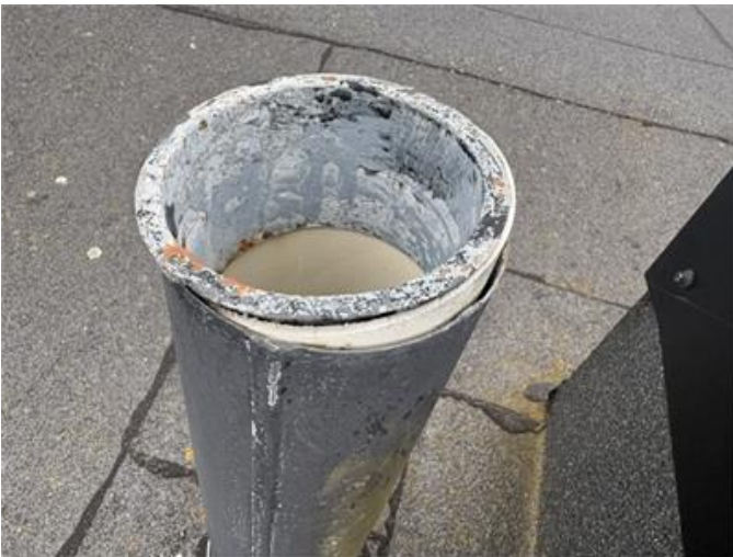
Bilden visar otätheter/brister vid/med avloppsluften.
