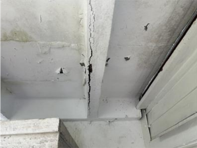
Bilden visar exempel på sprickor/materialsläpp i balkongen.
