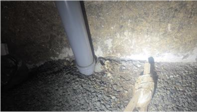
Täcklock saknas på avloppsrör, krypgrund tillbyggnad.
