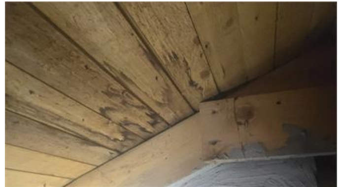
Exempelbild, fuktfläck i underlagstak, vind.
