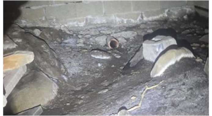
Rör i krypgrund, äldre del samt fritt vatten på mark.
