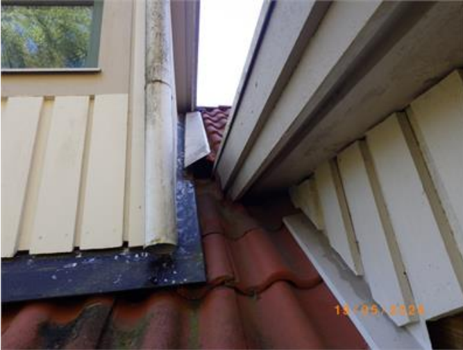
Plåtar täcker bristfälligt över takpannor.
