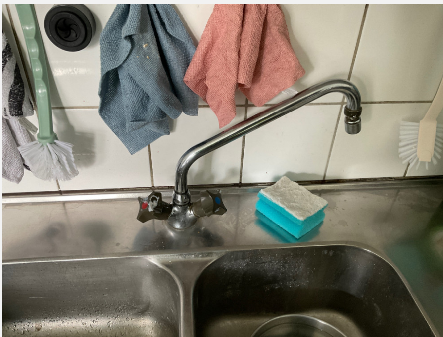
U4 Övrigt - Pip köksblandare ej begränsad. Risk för att utläckande vatten hamnar utanför diskbänk.
