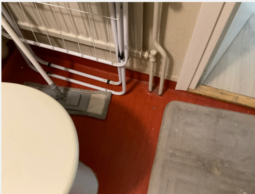
U2 Övrigt - Genomföringar i golv. Behöver åtgärdas vid framtida renovering.
