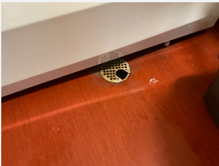
U3 Övrigt - Golvbrunn behöver bytas vid framtida renovering.
