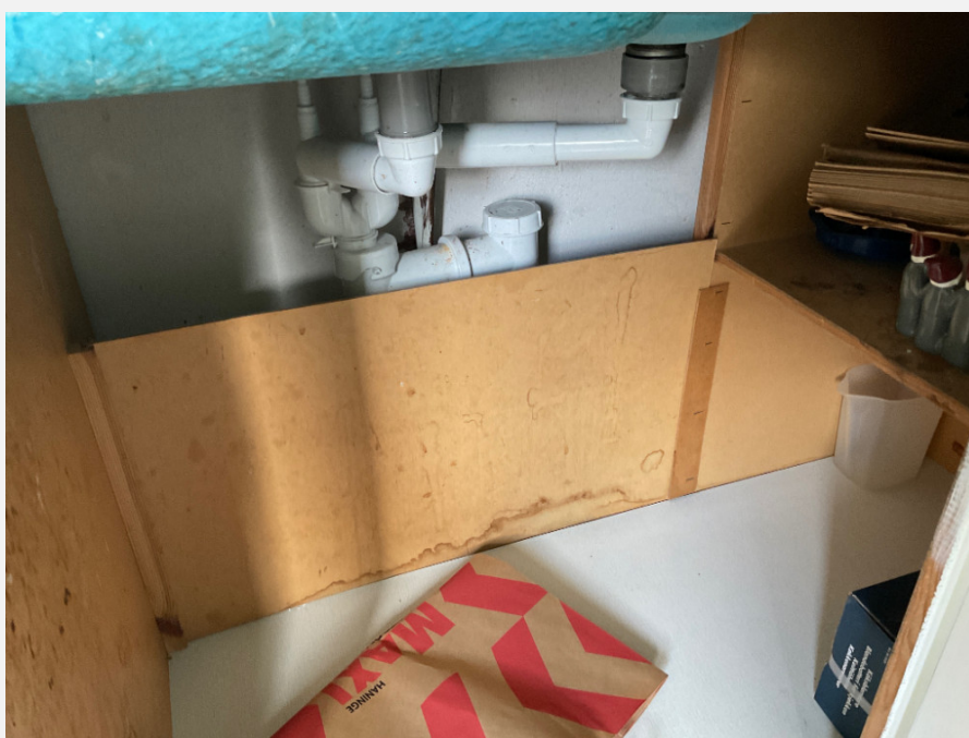
U5 Övrigt - Läckageskydd saknas diskbänkskåp
