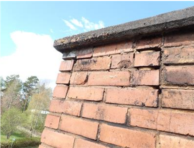
Skorsten som eroderat ovan tak.
