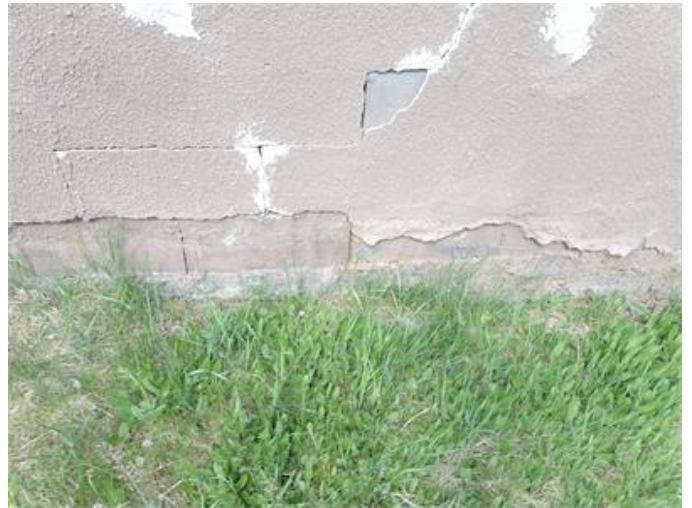
Exempel på putssläpp/sprickor i sockel.
