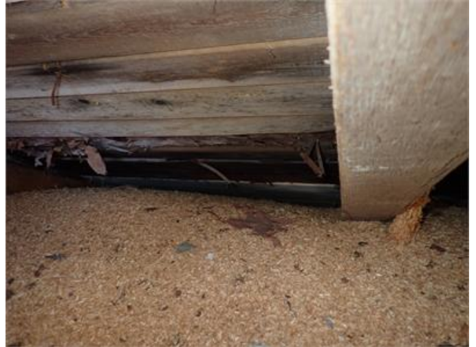
Exempel på mikrobiell påväxt på underlagstak vind.
