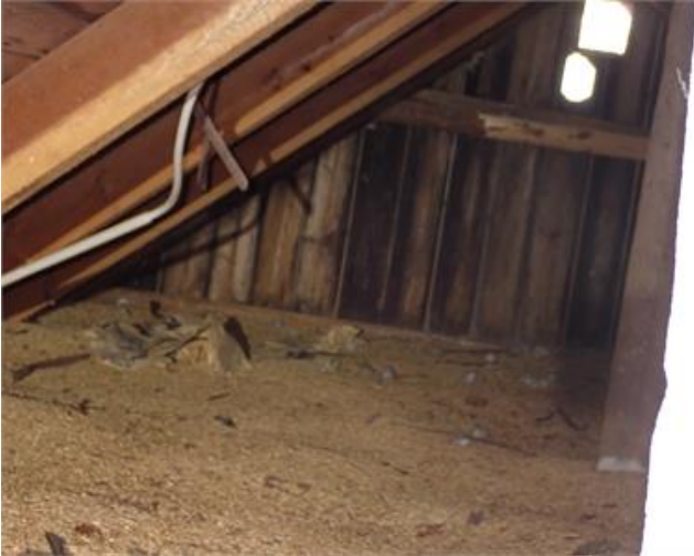
Exempel på mikrobiell påväxt på gavelspets vind.
