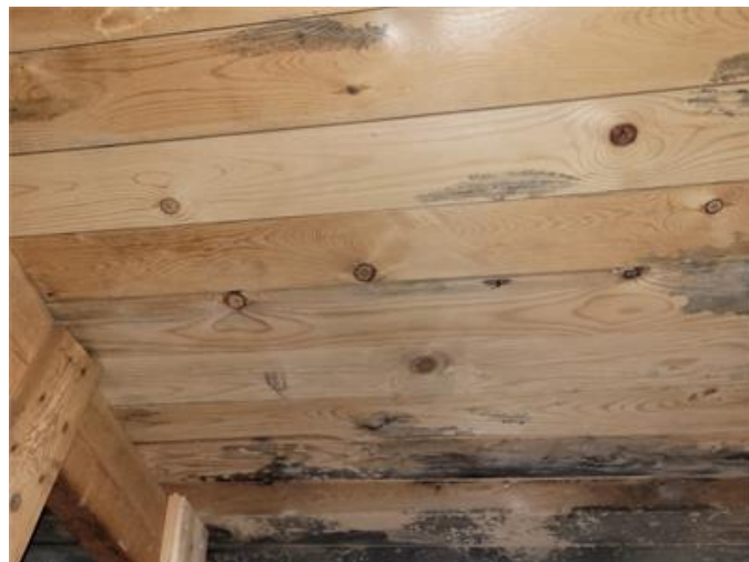
Mikrobiell påväxt på underlagstak
