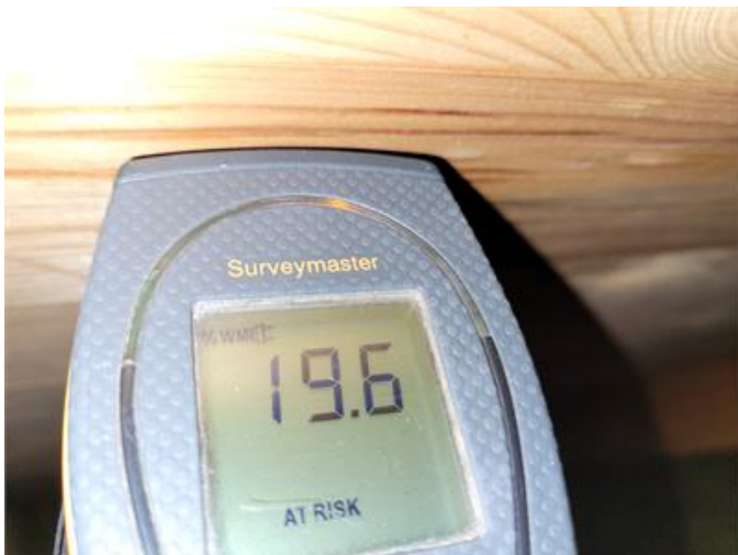
Förhöjd fuktkvot mättes upp i underlagstak
