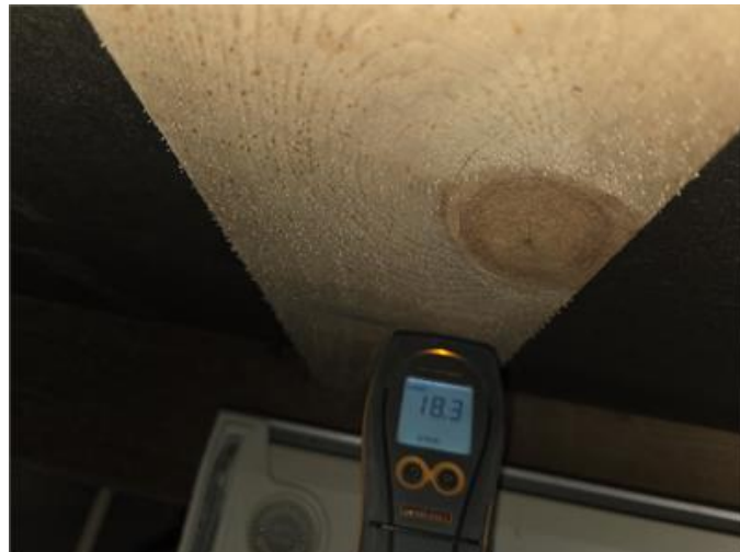
Förhöjd fuktkvot mättes upp i blindbotten
