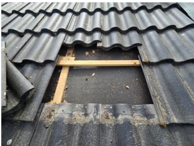
Tak: Stickprovskontroll under pannor, löv/frömjöl samt tunnare ströläkt noteras.
