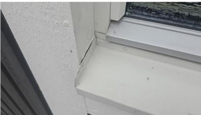
Exempelbild, otätheter kring fönsterbleck.
