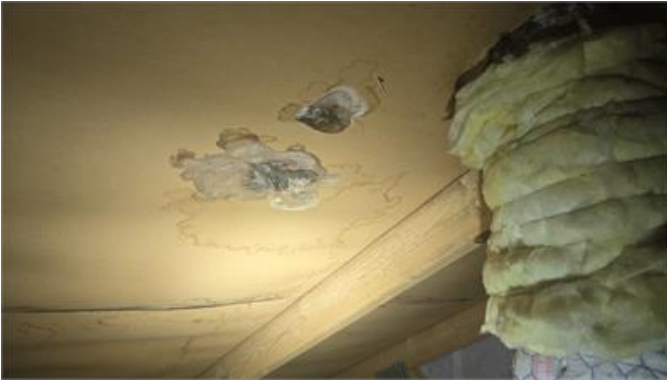
Fläckar intill genomföring ventilationsrör, vind.
