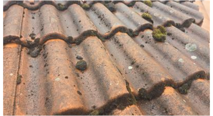
Exempelbild, mosspåväxt på takpannor och kantstött takpanna.
