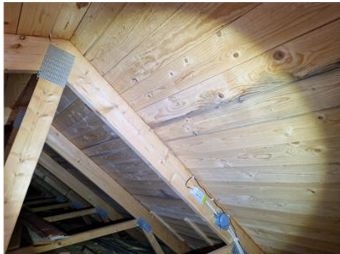
Garage: Fuktfläckar/missfärgningar förekommer i underlagstak på vind.
