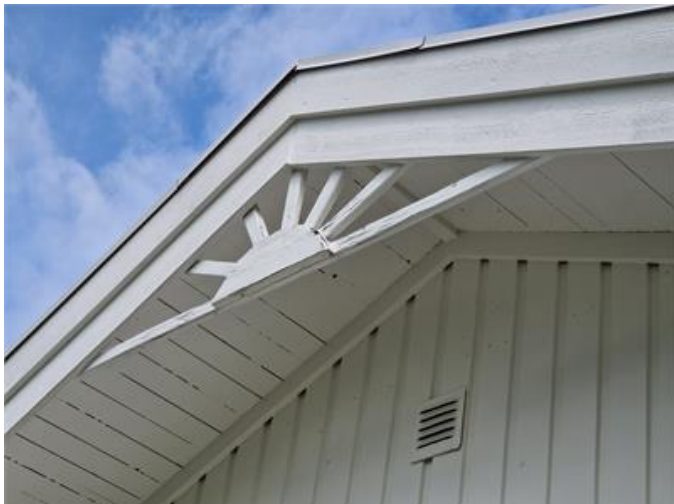
Fasad: Underhållsbehov/Skador noterades på fasadprydnad.
