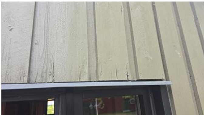
Exempelbild, rötskador och torrsprickor, fasadbrädor.
