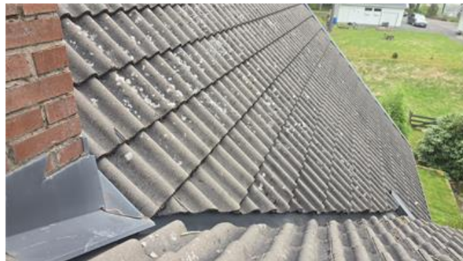
Översiktsgörning, del av yttertak. En skadad takpanna synlig.
