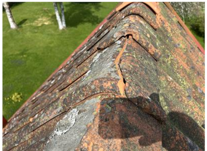
Tak: Spruckna pannor förekommer på flera ställen.
