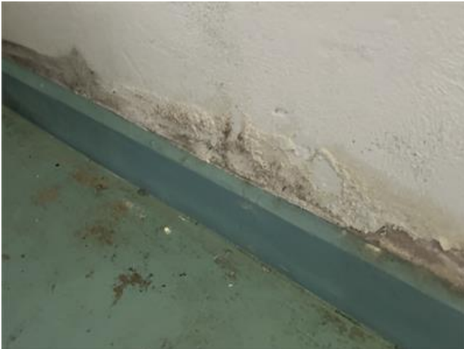
Källare: Fuktgenomslag, färgsläpp och mineralutfällningar förekommer.
