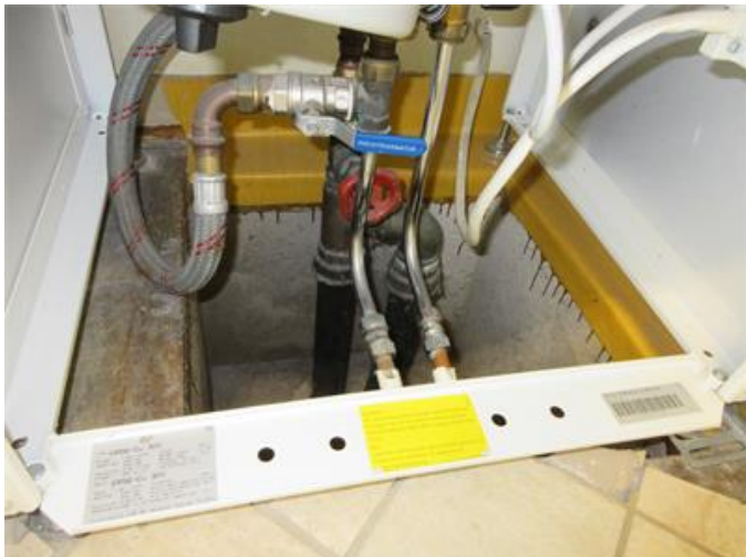
Inget tätskikt i utrymme under varmvattenberedare
