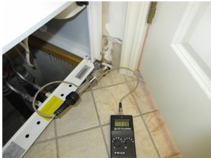
Fuktmätning i innerväggsyll i tvättstuga
