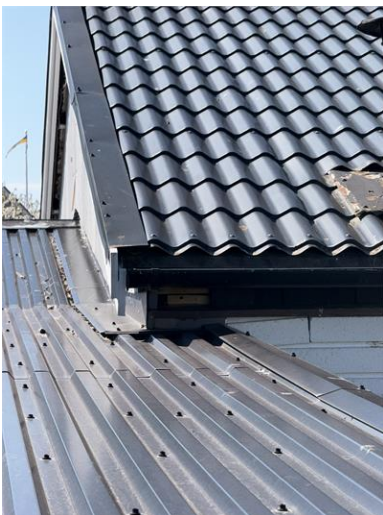
Panelbräda saknas mot takfot.
