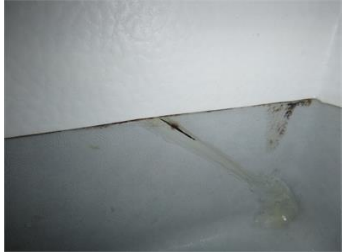
Bilden visar otäthet i vägg/golvmattans uppvik.
