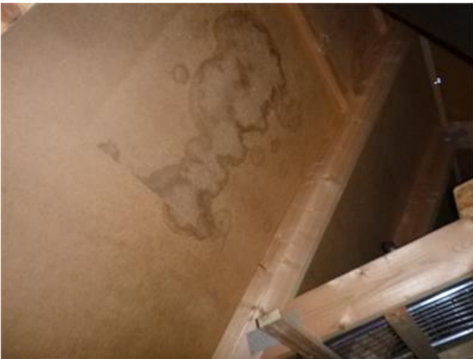
Bilden visar exempel på missfärgning (vind).
