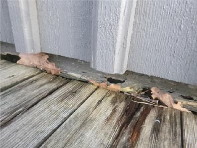
Bilden visar exempel på trädetalj (bakom altan) där rötskador förekommer.
