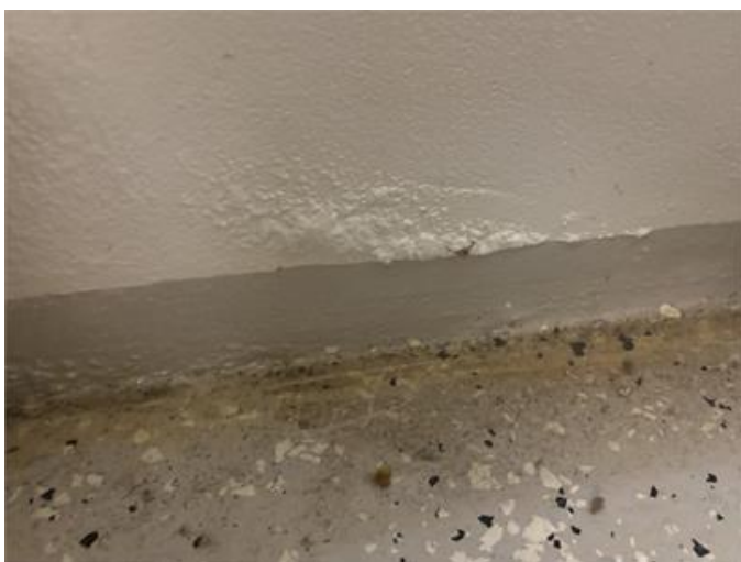
Färgsläpp i nederkant av vägg på del av källarvägg
