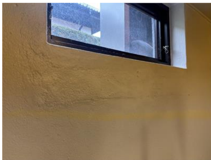
Färg och putssläpp samt förhöjda fuktindikationer under källarfönster i pannrum
