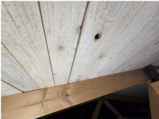
Mikrobiell påväxt på underlagstak
