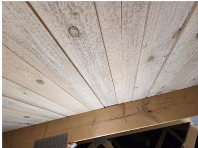
Mikrobiell påväxt på underlagstak
