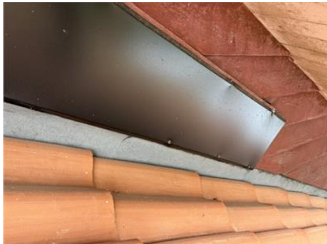
Bilden visar exempel på otätheter/brister där taket möter fasaden.
