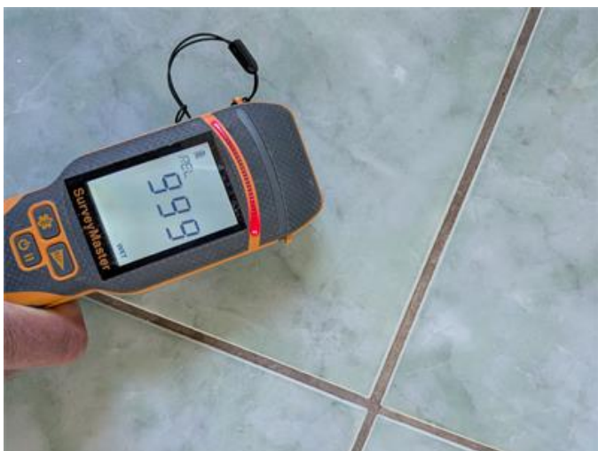
Förhöjd fuktindikering på golv i Dusch/WC
