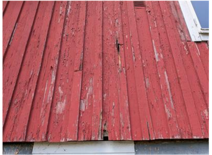
Rötskador finns lokalt i fasadpanel.
