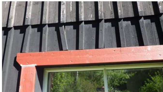
Lock, på fasadpanelen, som inte är erforderligt fastsatta och är otäta
