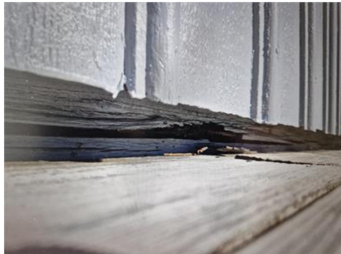
Fasad, rötskada i liggande panelbräda innanför altanen.
