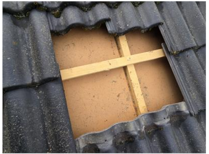
Tak: Stickprovskontroll under pannor på ursprungshus, träfiberskivor utan yttre täckning av papp.
