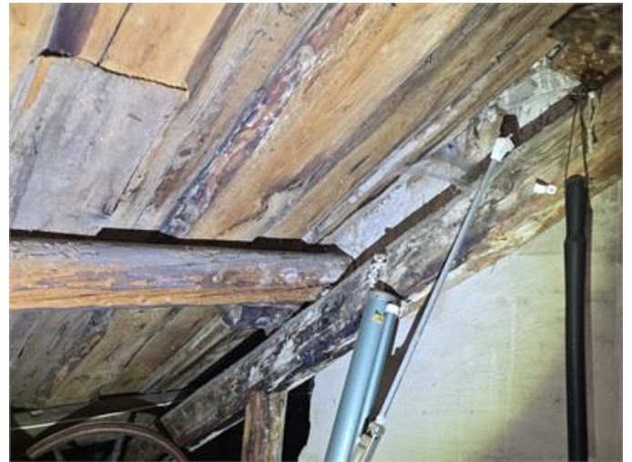
Nockvind ursprungshus: Fuktfläckar/missfärgningar noteras i underlagstak, torrt vid besiktning.
