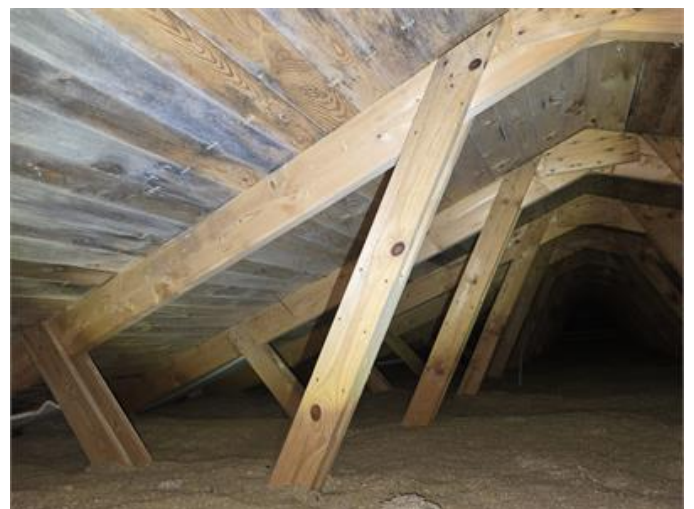
Nockvind tillbyggnad: Exempelbild på mikrobiell påväxt på underlagstak.
