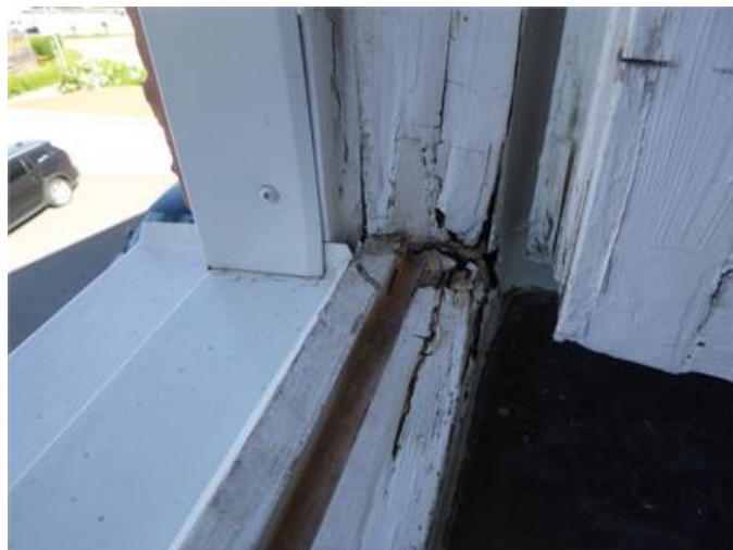
Rötskadat fönster i lilla lägenheten
