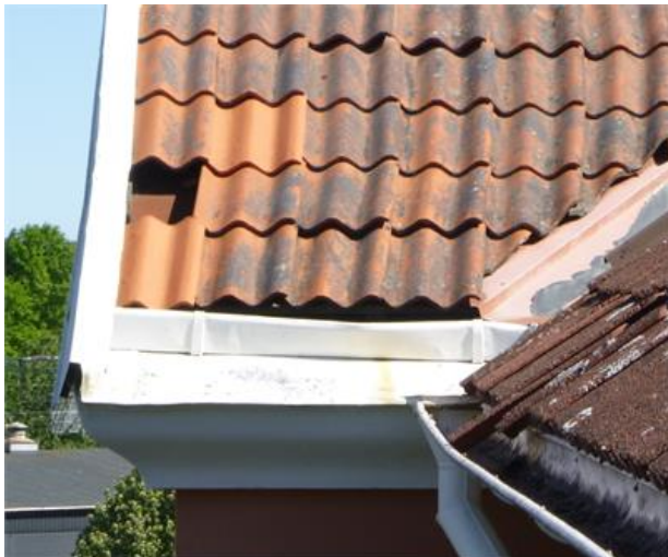
Takpannor som är ur läge
