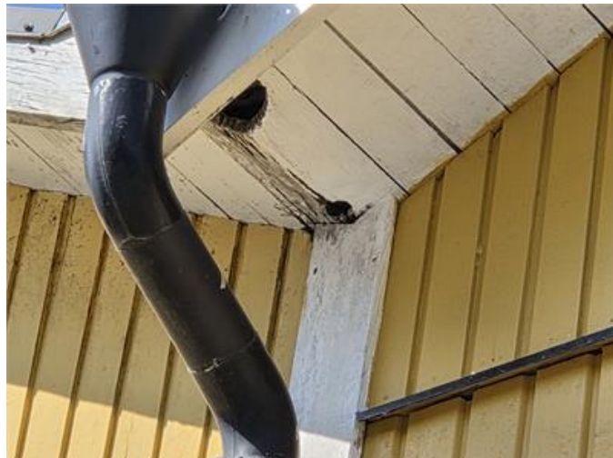
Rötskada på taksprång.
