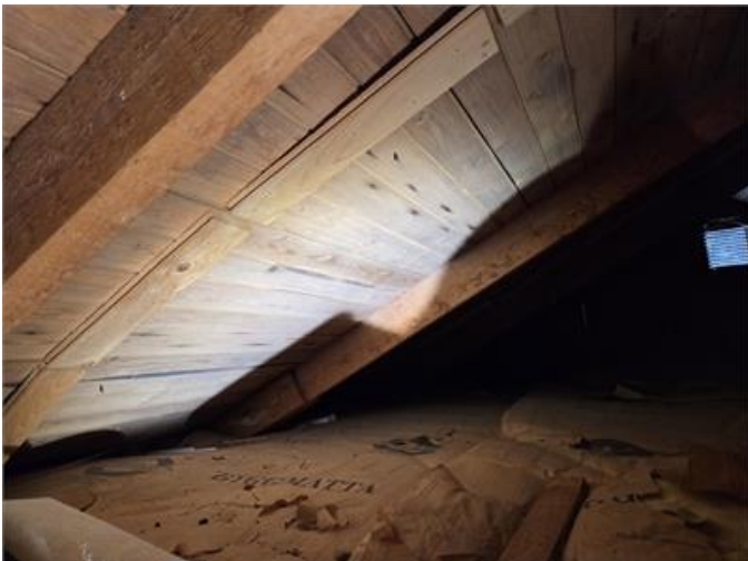
Mikrobiell påväxt på underlagstak
