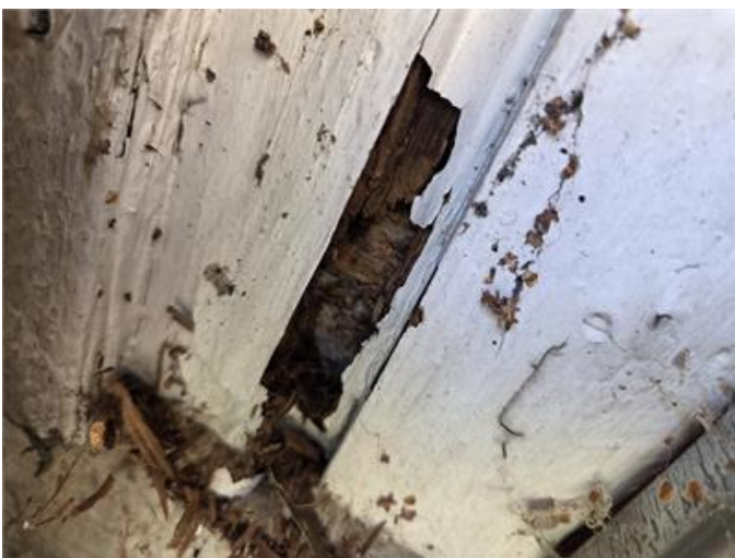
Rötskadad fasad invid entrédörr.
