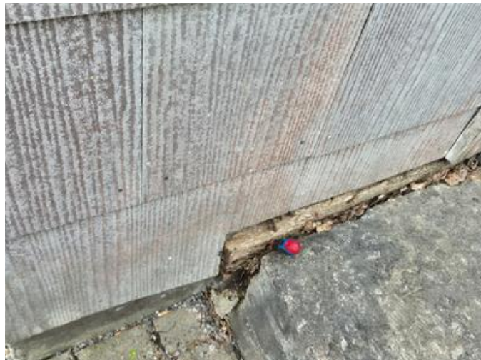
Rötskada vid verandan.
