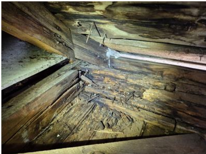
Bild på rötskada vid vinden.
