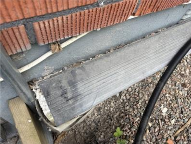
Bilden visar exempel på otätheter/brister vid/med grundens fuktskydd/isolering.
