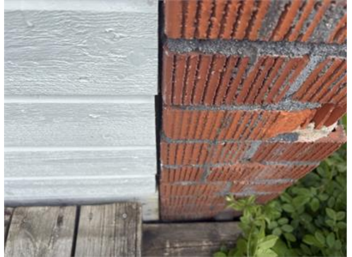
Bilden visar exempel på otätheter/brister i fasaden.
