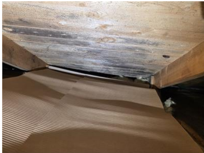
Mikrobiell påväxt på underlagstak.
