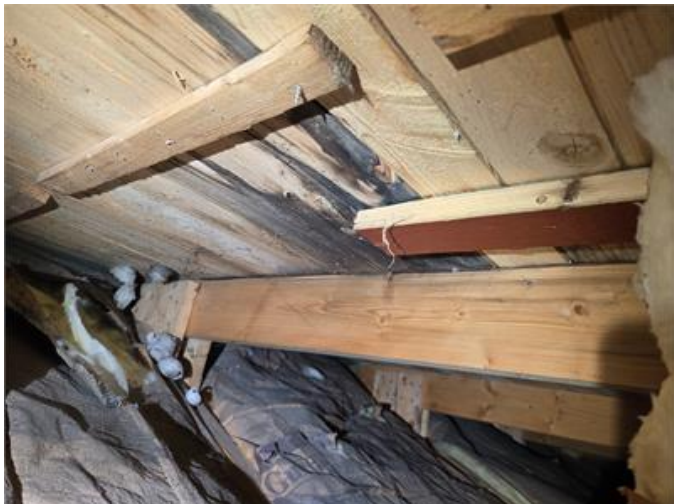
Äldre fuktfläck på underlagstak.
