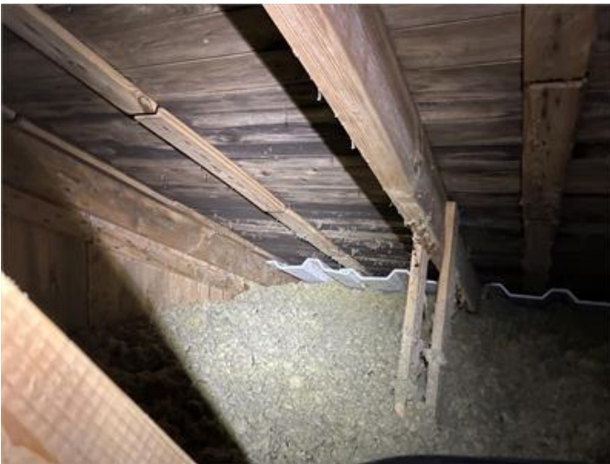
Nockvind: Mikrobiell påväxt på underlagstaket.
