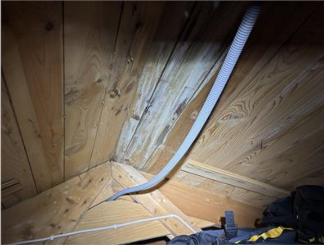
Nockvind: Bilden visar missfärgningar i nock, torrt vid besiktningsstillfället.
