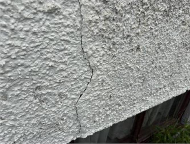
Bilden visar exempel på spricka i fasaden.
