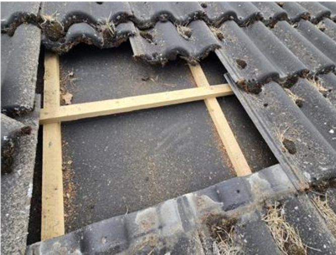
Tak: Stickprovskontroll under pannor, löv/frömjöl under pannor.
