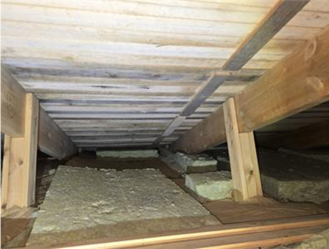
Nockvind: Mikrobiell påväxt noteras på underlagstak.
