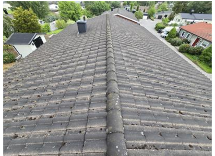
Tak: Översiktsbild, mossa/påväxt på pannor.
