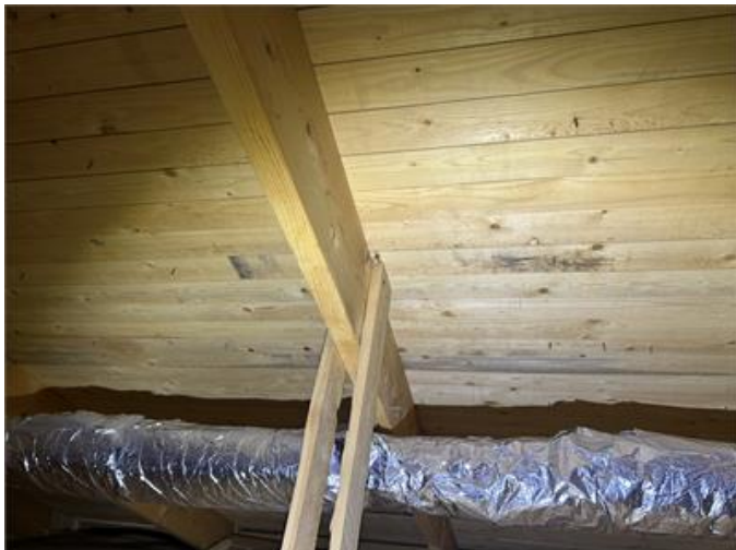
Nockvind: Missfärgningar i underlagstaket noteras.
