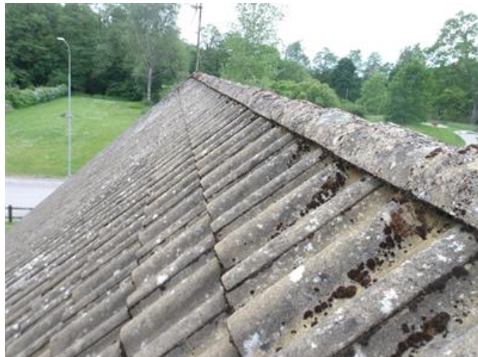
Tak: Tak från husets ursprung, se vidare under kommentarer och riskanalys på sida 4
