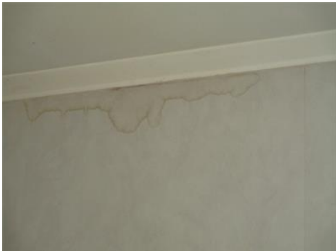
Fuktfäckar i kök
