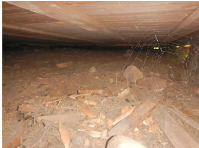
Byggspill på marken under huset
