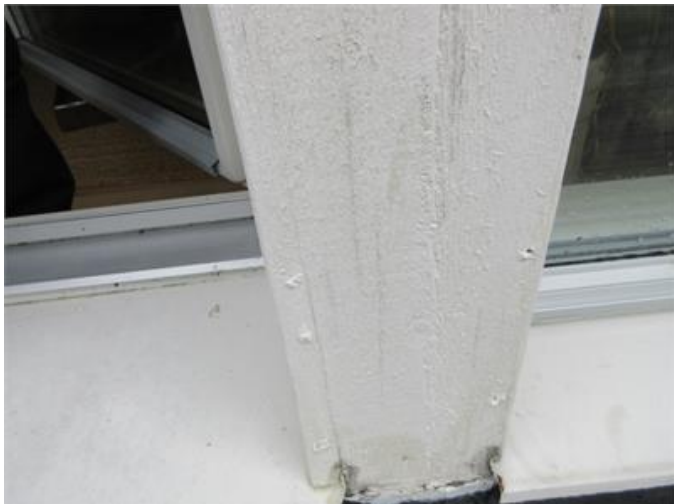
Bild visar exempel på underhåll i fasad på balkong
