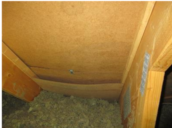
Missfärgningar insida yttertak inockvind
