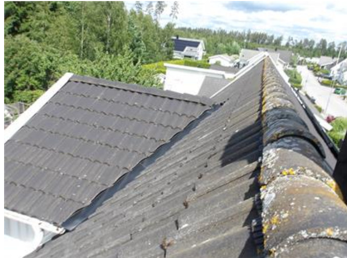
Tak: Taken är klädda med betongpannor, bostadshuset har ett undertak av Masonit och garaget har trä och underlagspapp/duk.
