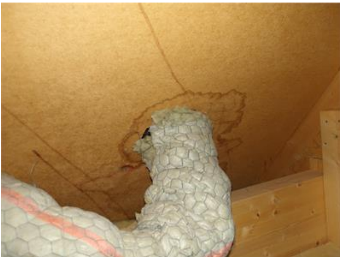
Nockvind/bostadshus: Det noterades lokala spår av fuktinträningar på undertaket runt rör genomföringar (uttorkade vid besiktningen) vilket kan anses vara normalt för ett undertak av Masonit vilket kan ske vid viss väderlek.
