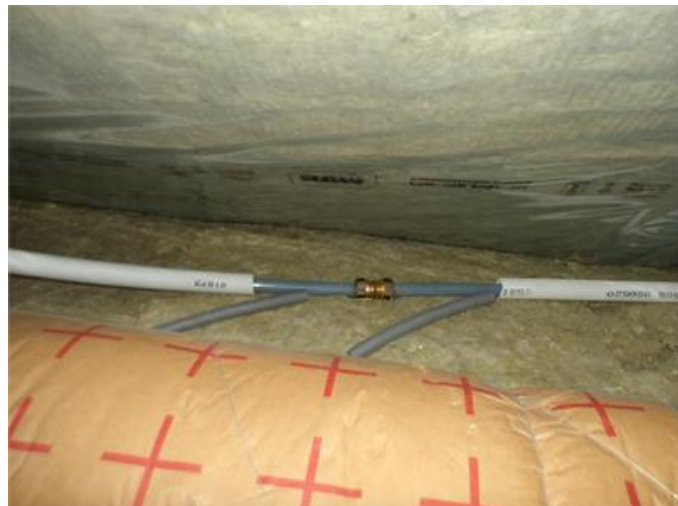
Övre plan/Sidogarderob: I den ena sidovinden finns skarvar till rörledningar och kopplingar till värmesystemet utan vattentätt golv eller läckageindikering. Risk finns att eventuella läckage leder till fuktskada.
