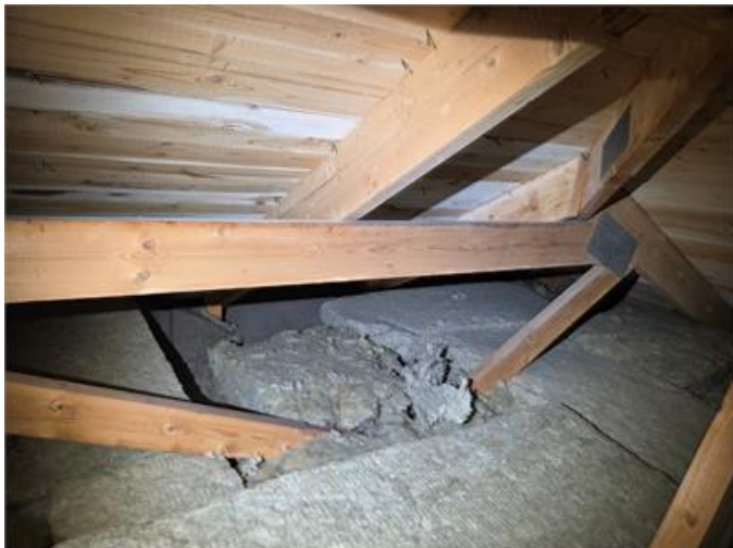
Mikrobiell påväxt samt fuktfläckar på underlagstak.
