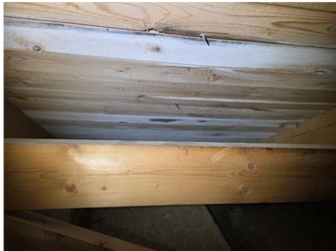
Mikrobiell påväxt samt fuktfläckar på underlagstak.
