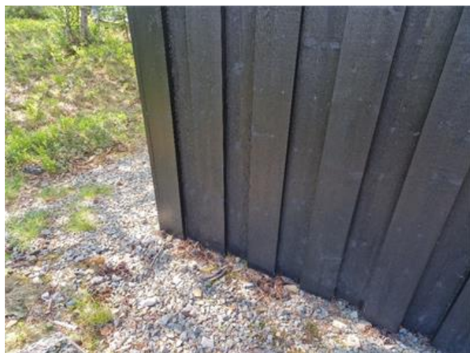
Delar av fasad är marknära.
