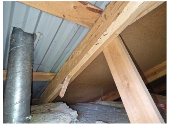
Mindre del av besiktad vind saknar underlagstak.
