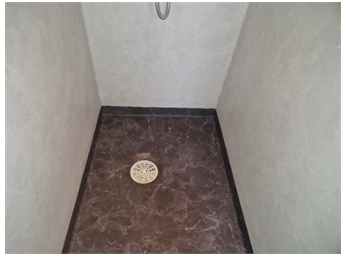
Äldre golvbrunn förekommer i renoverat utrymme.
