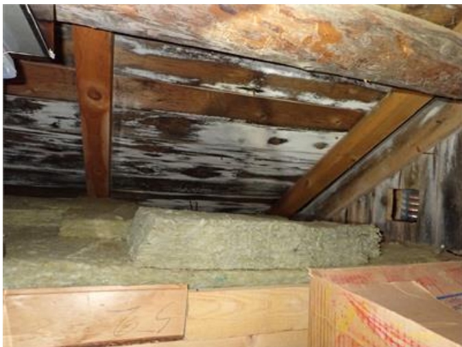
Exempel på mikrobiell påväxt på underlagstak vind.
