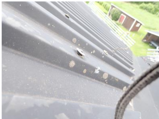
Exempel på plåtspik som är otät i infästning på tak.
