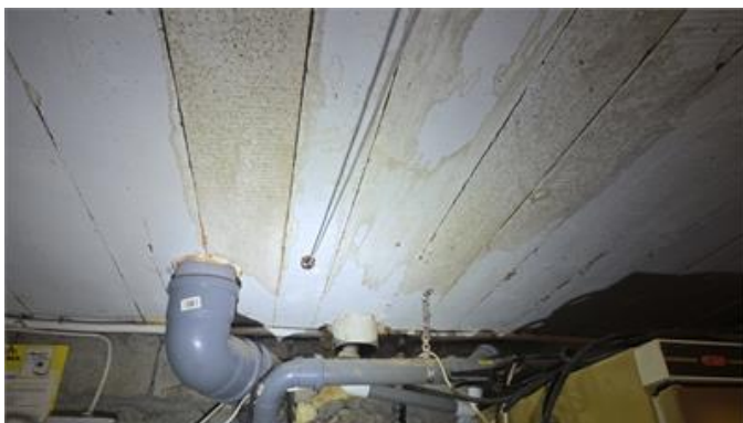
Fuktfläckar i tak, tvättstuga. (Under dusch/Wc på övre plan)
