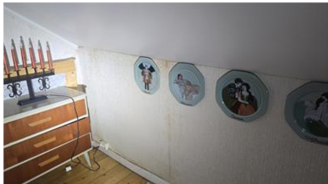
Exempelbild, missfärgningar vägg, sovrum övre plan.
