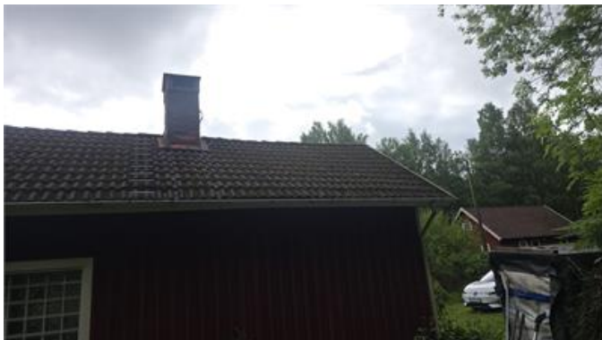
Översiktsbild, del av yttertak med mosspåväxt.
