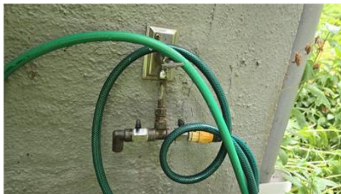
Ombyggd väggvattenutkastare, ej längre fryssäker i detta utförande.
