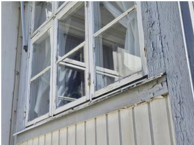
Äldre fasad och fönster med delvis bytesbehov.
