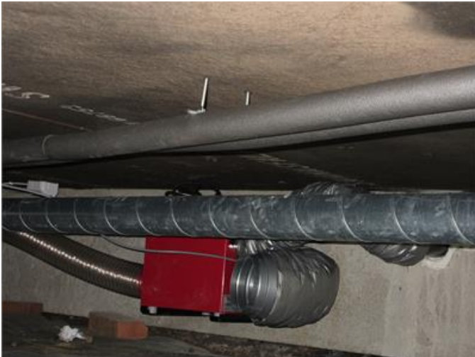
Installerad avfuktare i grund
