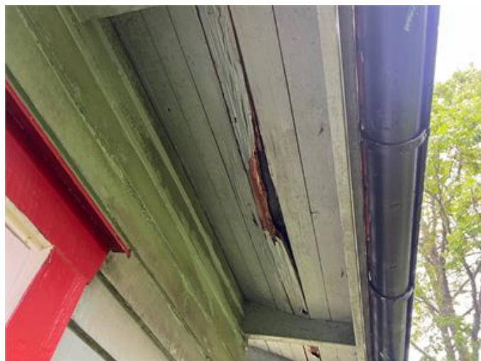
Rötskada vid takutsprång.
