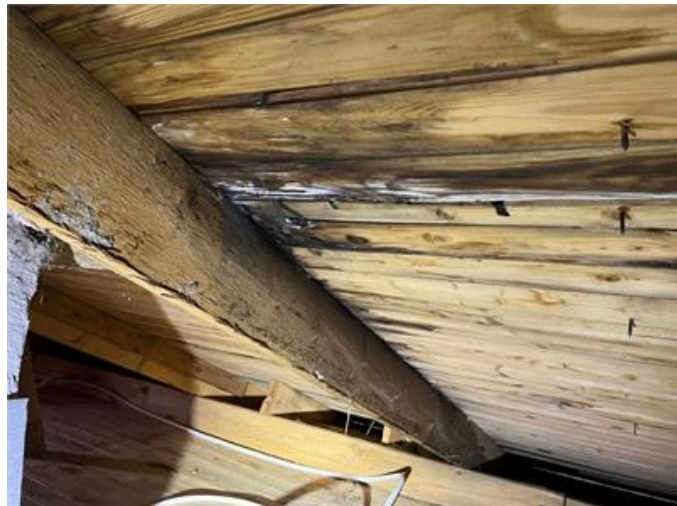
Exempel på fuktfläckar i underlagstak i vindsutrymme.
