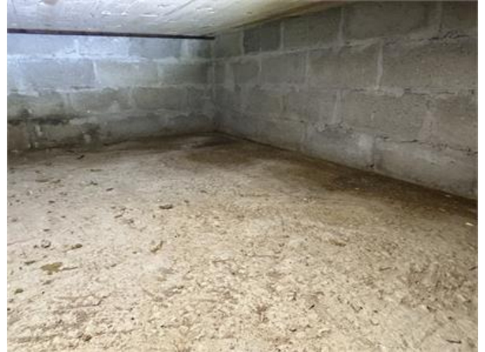
Krypgrund: Fuktgenomslag i grundmuren och golv.
