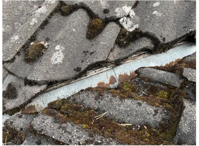
Tak: Rötskadade läkt noteras främst i rännal.
