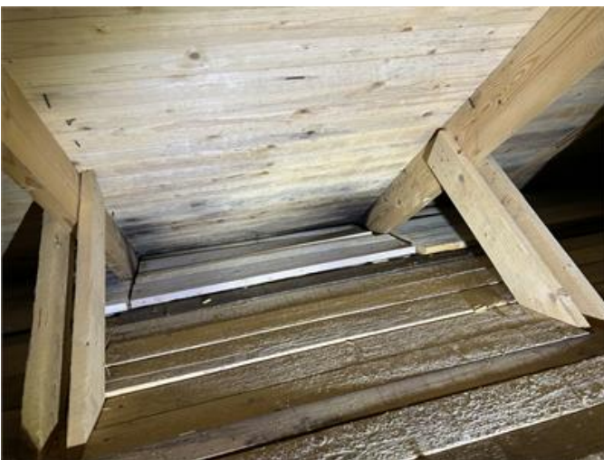
Nockvind söder: Mikrobiell påväxt vid främst takfoten. Takfotsventilation finns ej.
