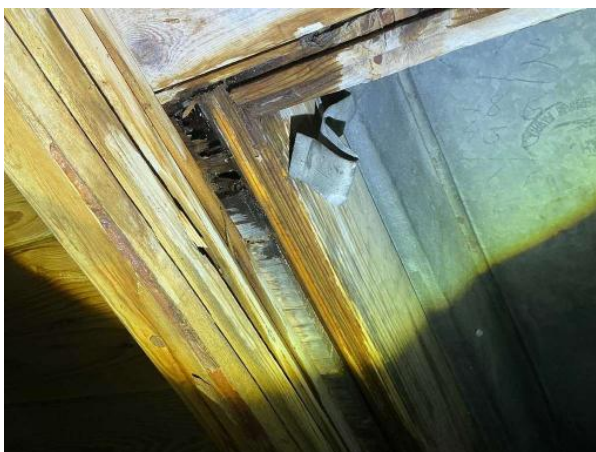
Bild 2: - Utvändigt, Vind, Läckage runt takluckan
