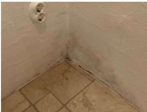
Bild 4: - Invändigt, Källarplan, Missfärgningar noterades på yttreväggar Bomjud noterades på putsen
