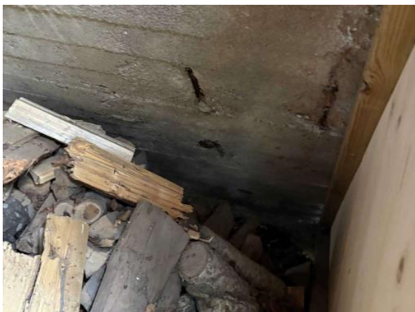
Bild 3: Utvändigt, Övrigt, Synlig rostig armering noterades under trappan
