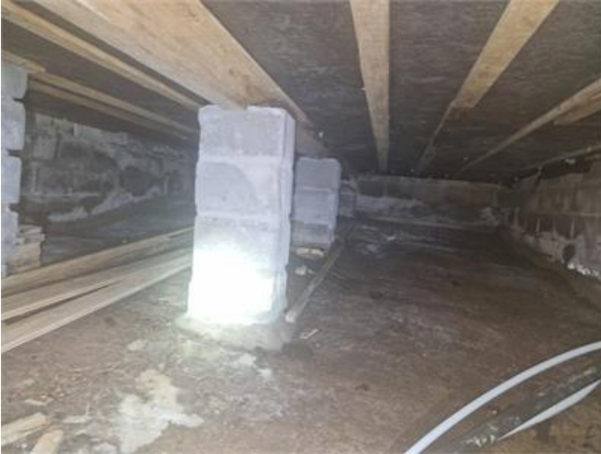
Krypgrund, fuktig miljö och svampangrepp på marken.
