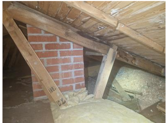
Nockvind, torra fuktanvisningar i underlagstaket, bristfällig isolering nedan murstock.
