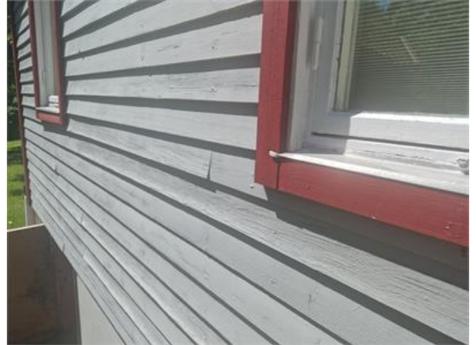
Fasad och Fönster, äldre med färgsläpp, plåtbleck olämplig utformning.
