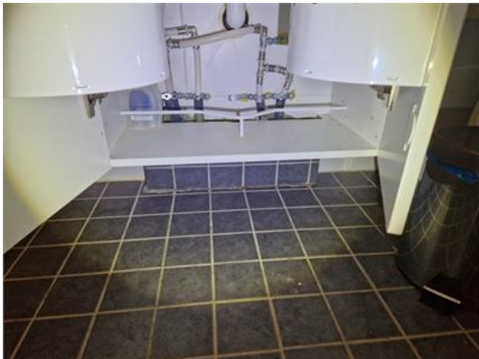
Dusch/Wc/Bastu: Rör genomföringar i golv ej åtkomliga
