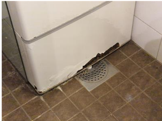
Dusch/wc/Tvättstuga: Rostangrepp förekommer på värmepump.
