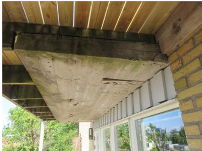
Sprickor/frostsprängningar i undersida balkong
